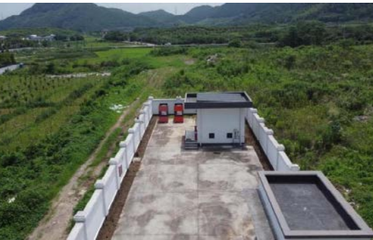
燃气微管网项目设施
