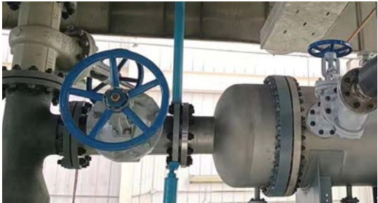
改造后增添的管壳式气水换热器
