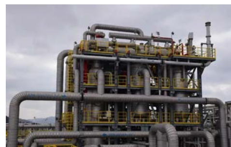
• 舟山接收站 LNG 气化冷能综合利用系统
