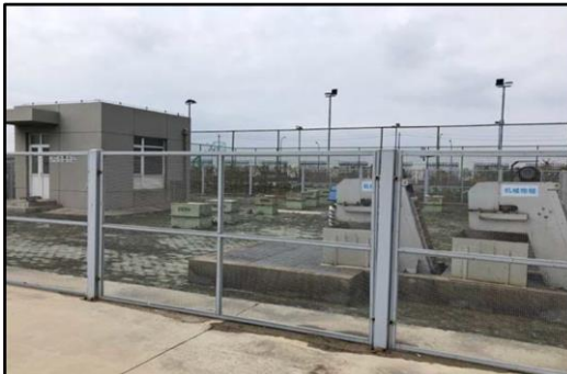
生活污水处理站
