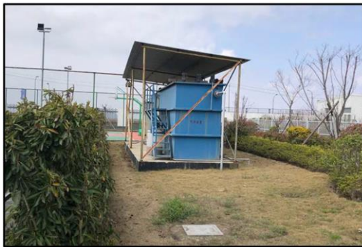
含油污水处理站
