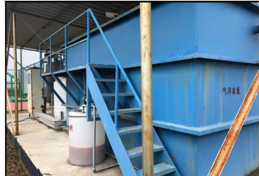
含油污水处理站
